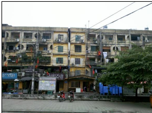
Рис. 2. Неравномерные осадки зданий в районе Зангво центра Ханоя
