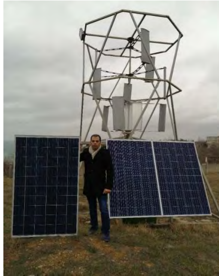
Рис. 3. Ветер / солнечная гибридная система питания на полигоне Сев ГУ на турбазе Горизонт
